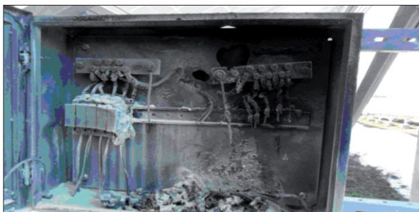
Rys 1: Spalona rozdzielnica DC
