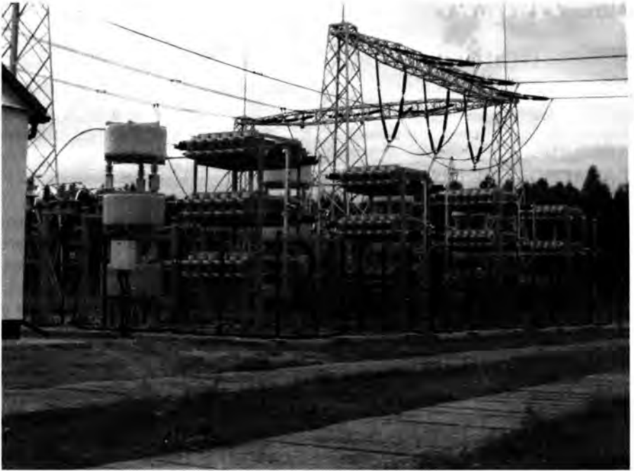
Widok stanowiska baterii kondensatorów
