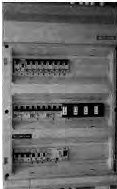
Rys.9. Ochrona przepięciowa w tablicy rozdzielczej
