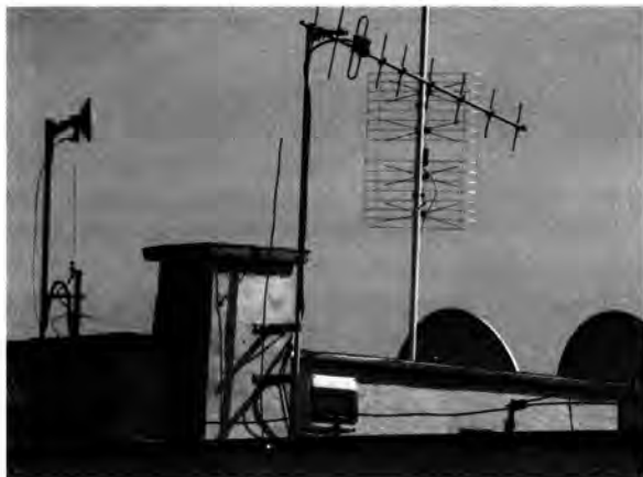
Rys.8. Błędne rozwiązanie instalacji odgromowej -zwody pionowe niższe niż maszty antenowe
