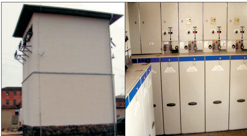
Rys. 9. Zmodernizowana stacja wieżowa RS Itowa z dwusekcyjną rozdzielnicą GAE [42, 53]
