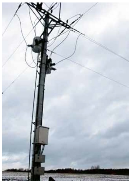
G200 zamontowany w szafce sterowniczej. Na odejściach widać zawieszane jednostki pomiarowe typu Flite116
