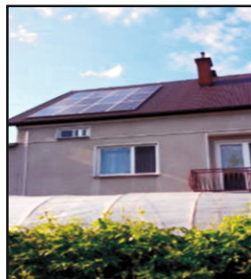
Widok paneli dla mikroinstalacji PV 3kWp na budynku jednorodzinny w miejscowości Niwka
