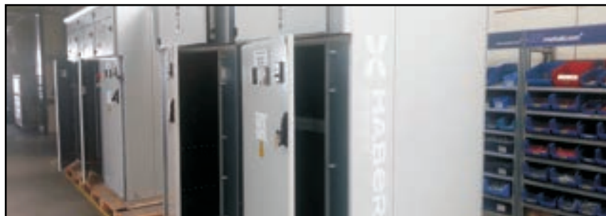
Rozdzielnice SN w procesie montażu Zakład HABER Energia Sp. z o.o. w Chełmie.
